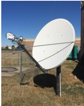
Fig 4 VSAT Satellite Antenna
